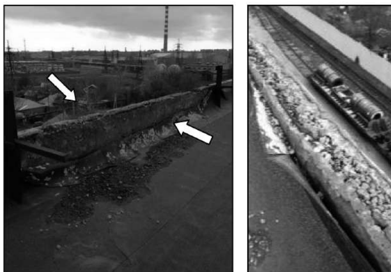
Рис. 9. Отсутствует фартук по парапету, отклеивание рулонного гидроизоляционного ковра, разрушение парапета
