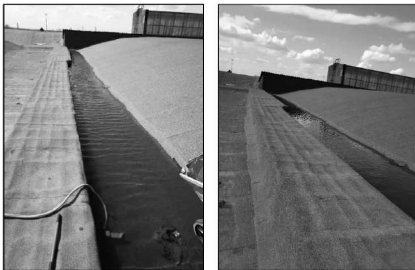
Рис. 12. Отсутствие воронки водостока, застой осадков на кровле
