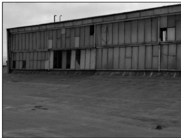
Рис. 13. Разрушение оконного заполнения светоаэрационных фонарей
