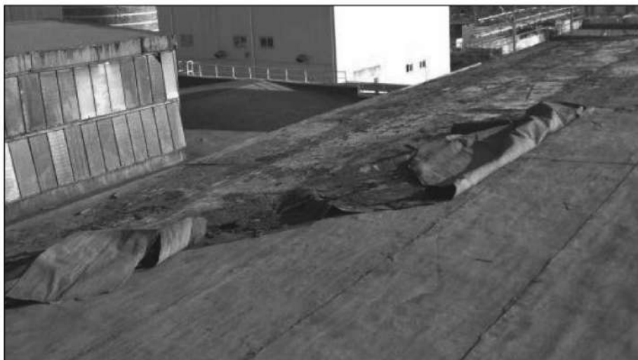
Рис. 3. Отрыв, отслоение кровельного материала
