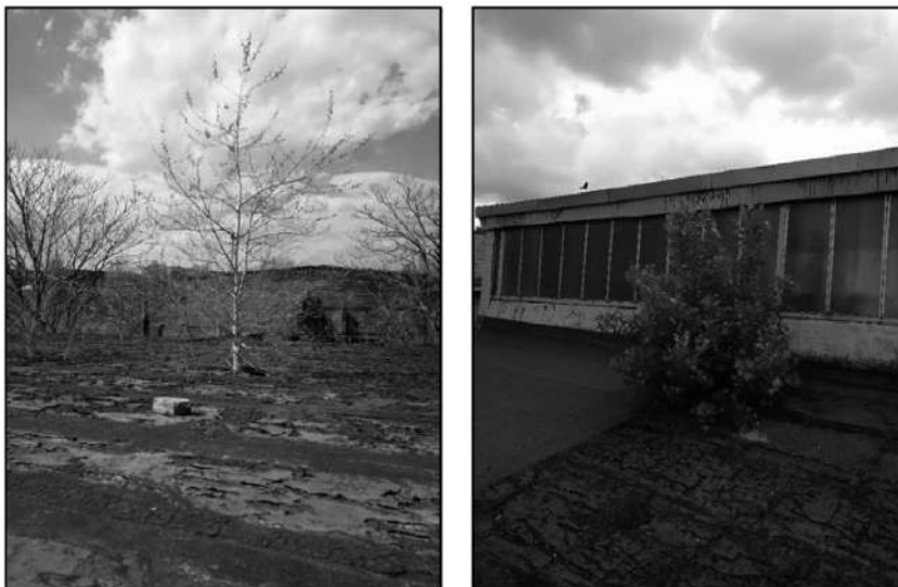
Рис. 7. Прорастание деревьев на кровле
