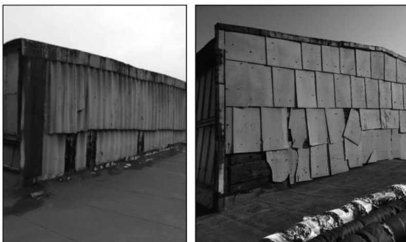
Рис. 15. Разрушение асбестоцементного ограждения фонарей
