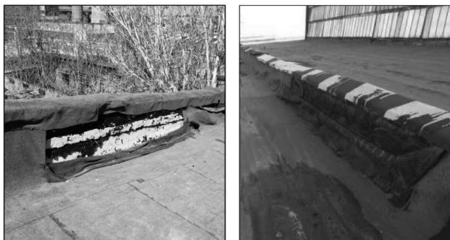
Рис. 4. Отклеивание рулонного ковра от вертикальных поверхностей
