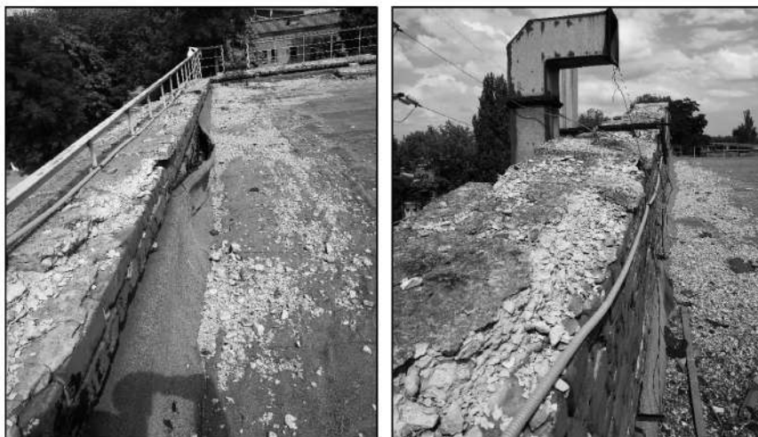
Рис. 10. Разрушение железобетонных парапетных плит
