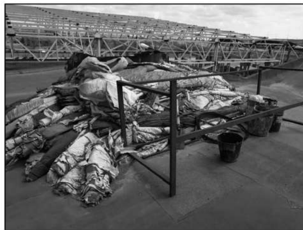
Рис. 5. Захламление кровли оставленными строительными материалами
